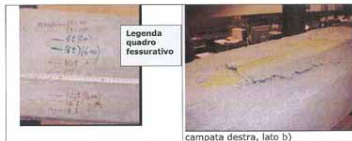
Fig. 22. Quadro fessurativo in corrispondenza dell'appoggio centrale.
