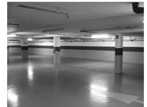
Figura 24: parcheggio multipiano realizzato con Pilastri PTC®
