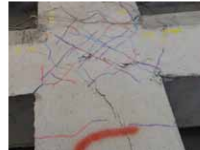
Figura 10 – Particolare del pannello del nodo N. 2 dopo la prova
