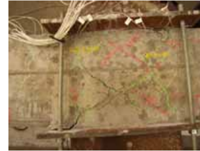
Figura 13 – Particolare del pannello del nodo N. 5 dopo la prova
