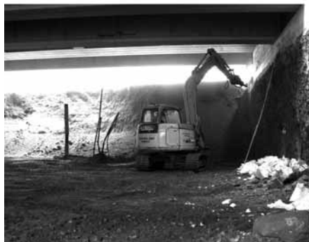
Figura 36: Top Down REP® nel cantiere per la nuova stazione metropolitana Garibaldi, Milano
