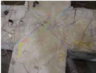
Figura 9 – Particolare del pannello del nodo N. 1 dopo la prova
