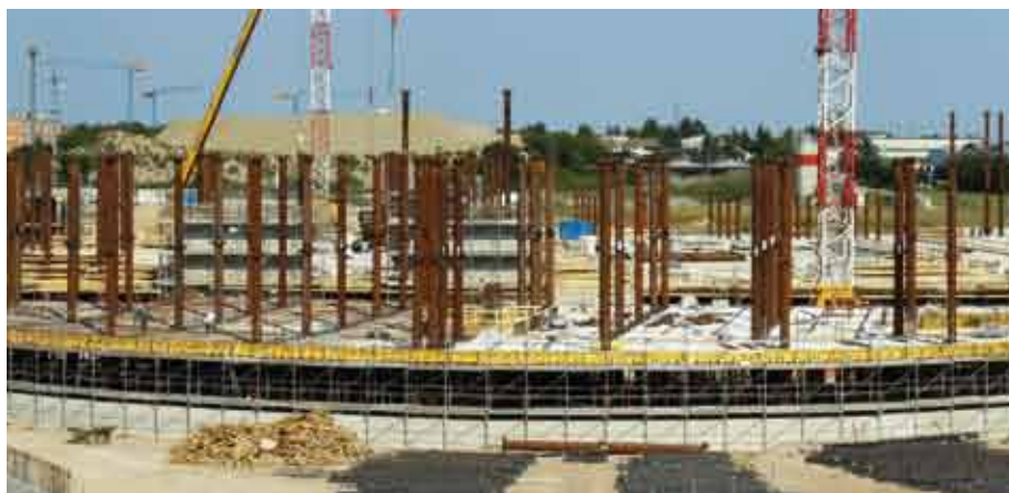
Opere di costruzione del nuovo plesso ospedaliero di Vimercate, realizzato con l'impiego di Pilastrini PDTI® pluripiano a sezione circolare in abbinamento a Travi REP® Nor. I 116.000 mq di impalcato sono stati realizzati in 6 mesi con una produttività di oltre 19.000 mq/mese.
