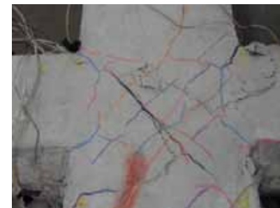
Figura 11 – Particolare del pannello del nodo N. 3 dopo la prova
