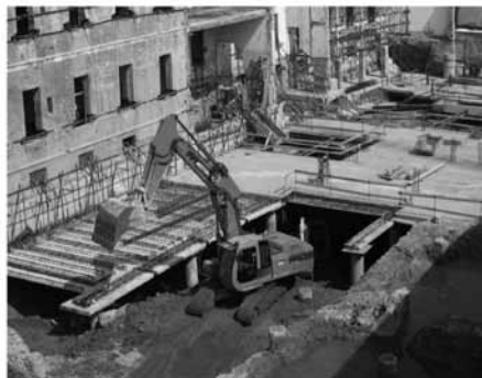
Figura 37: Top Down REP® nel cantiere di Piazza S. Leonardo, Università di Treviso
