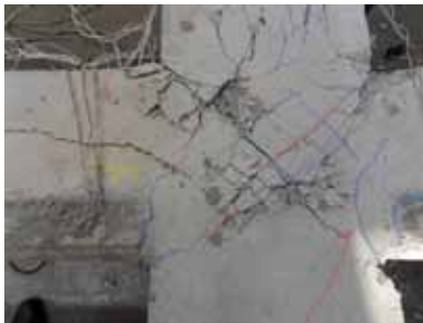
Figura 12 – Particolare del pannello del nodo N. 4 dopo la prova
