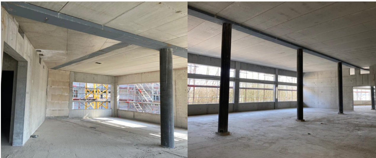
NPS® Basic Träger und NPS® PTC Stütze, Sky Campus Nordport
